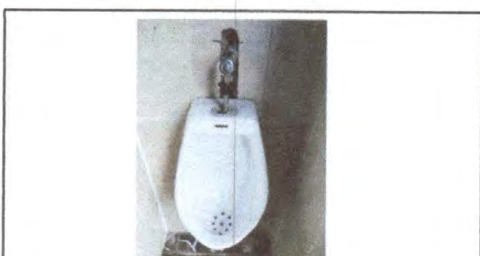
Foto 4: Sustrucción de mingitorio
